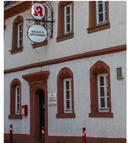
Der alte Eingang kann wegen der geforderten Barrierefreiheit nicht genutzt werden, eine neue Tür musste her
